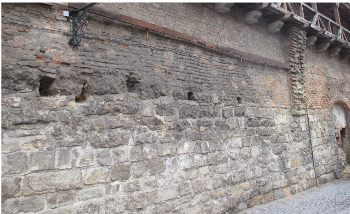
Рис.5.1.5. Фіксація стану збереження оборонних споруд монастиря оо. Бернардинів у Львові. Внутрішній фасад оборонного муру. Виявлено чорну патину та відшарування каменю, деструкцію цегляного мурування (світлина авт. 2016 р.).
